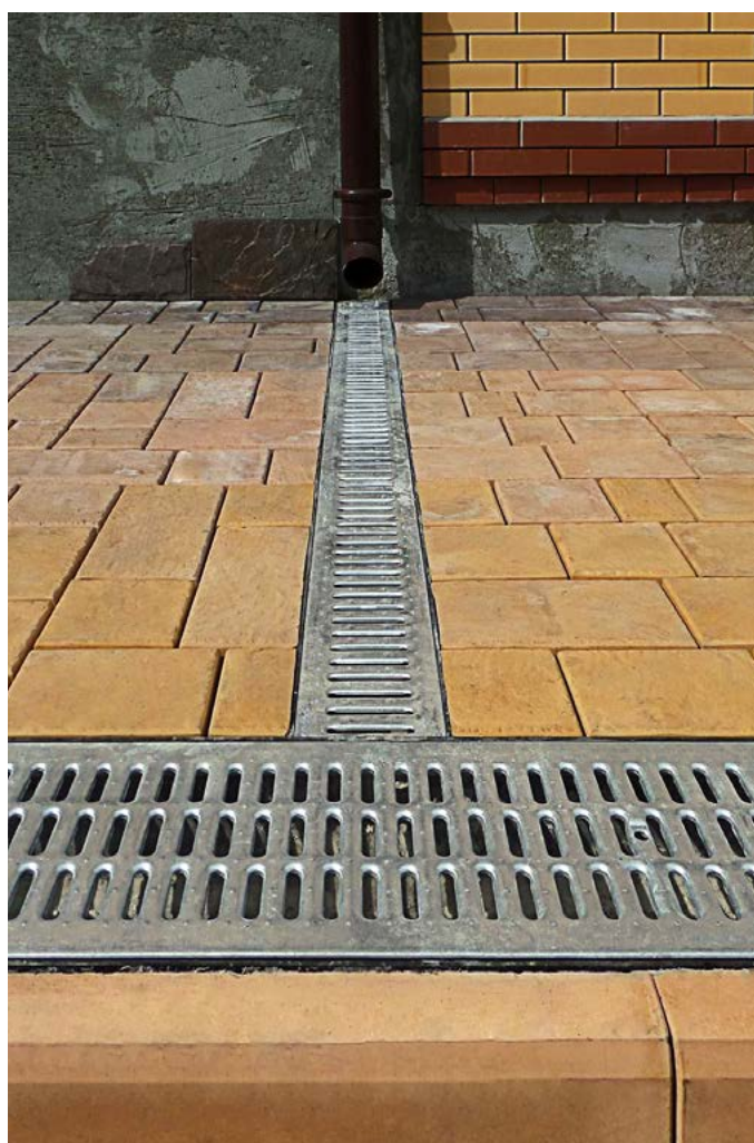
Частный дом, водоотводные лотки Hidrolica® Standart с оцинкованными решетками
