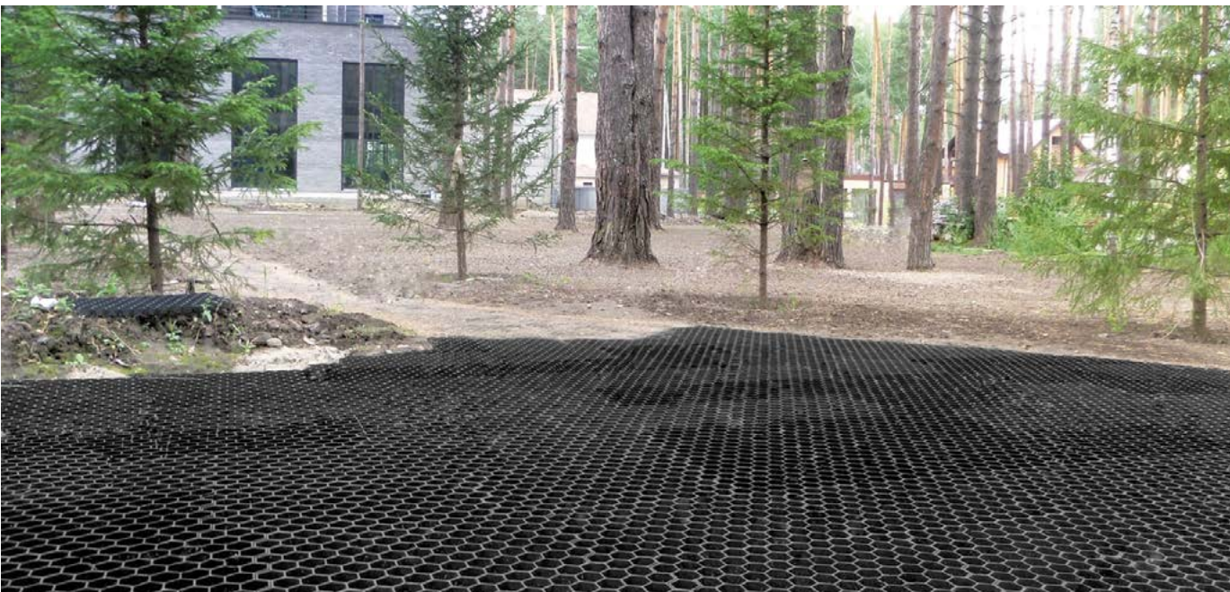
г. Новосибирск, частный дом, Экопарковка
