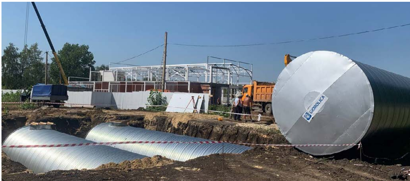
г. Елец, Липецкая обл., ФОК, емкость стальная Gidrolica Tank Water
