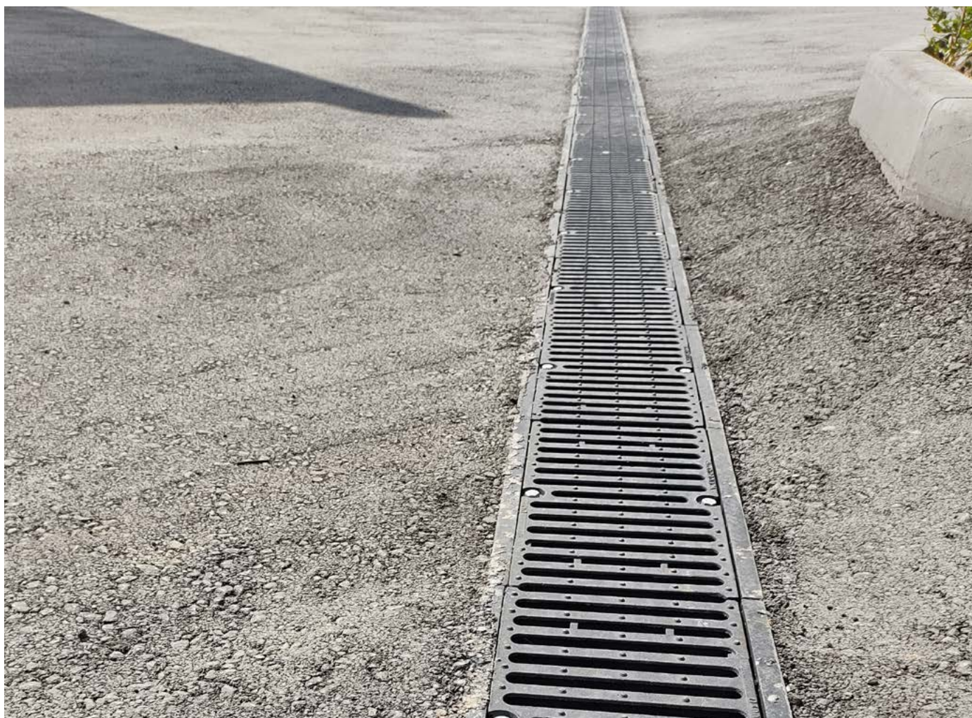
г. Новосибирск, ул. Титова, супермаркет, бетонные лотки BGZ-S
